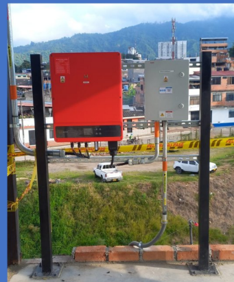
Imagen 5. Medio de Desconexión y inversor
